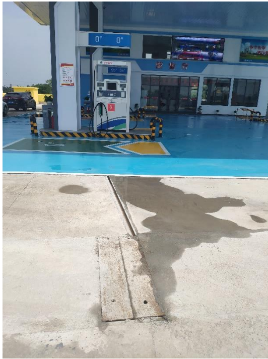
隔油沉砂池入口
